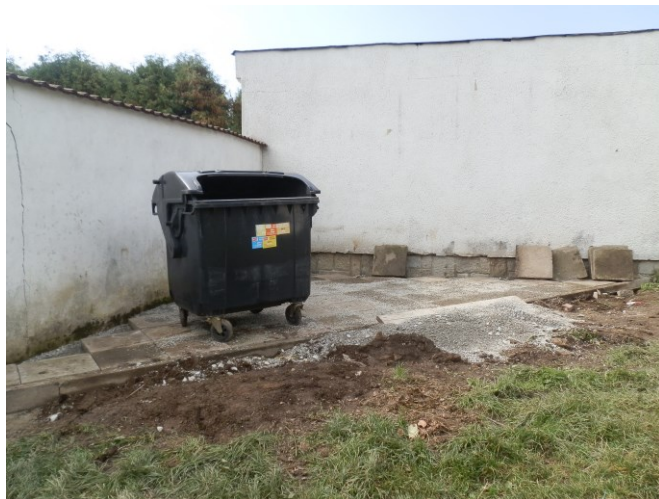
Upravený prostor pro ukládání odpadu ze hřbitova.
