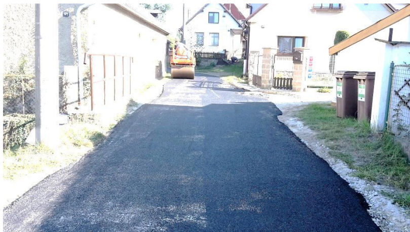
Povrch silnice na stráních.
