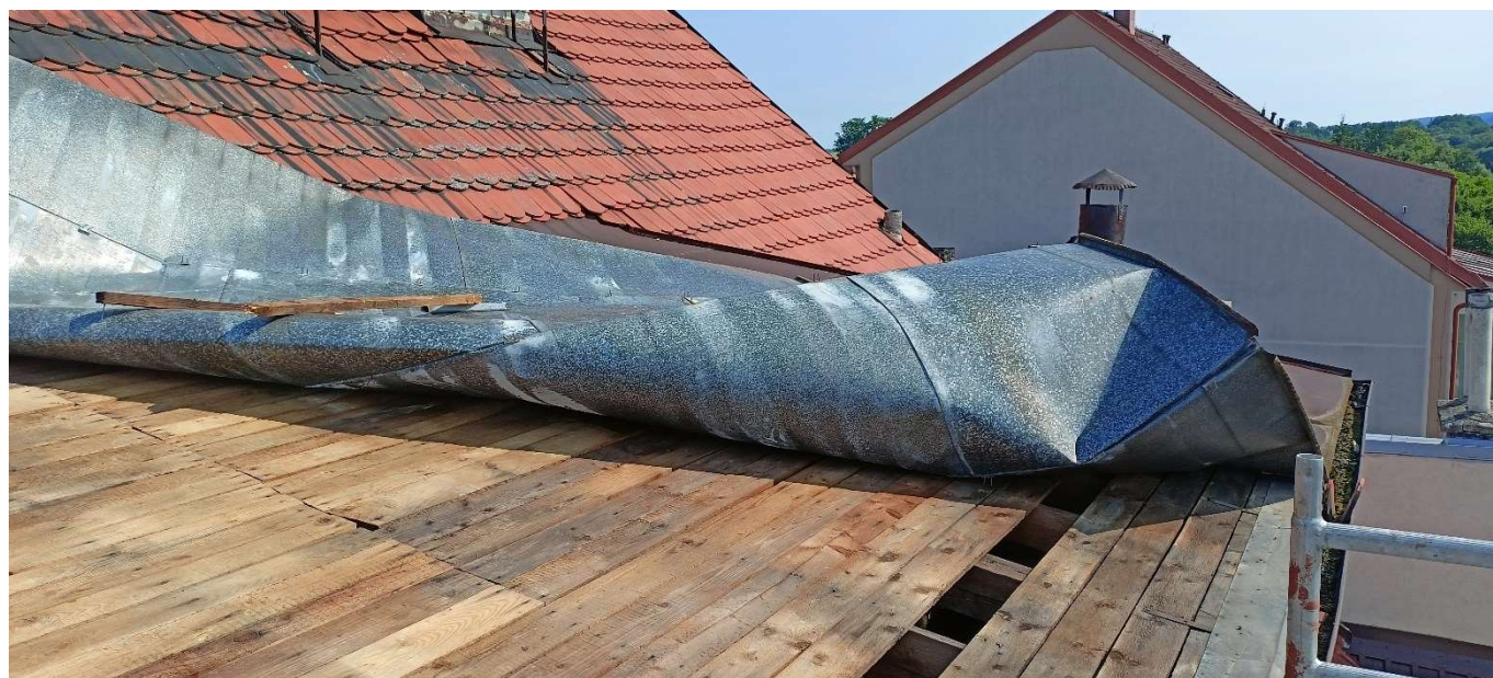
Poškozená střecha na čp. 9.
