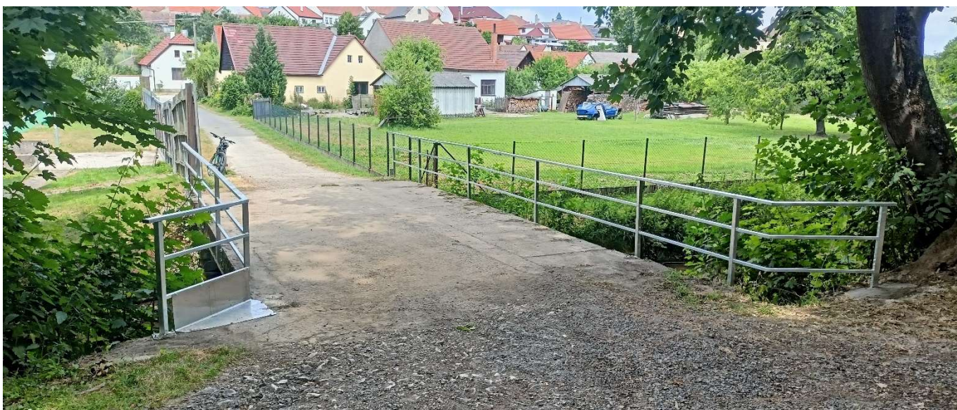
Zábradlí u areálu ČOV v Podfarské ulici.
