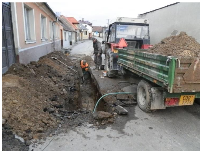
Porucha vodovodu ve Svatojánské ulici.
