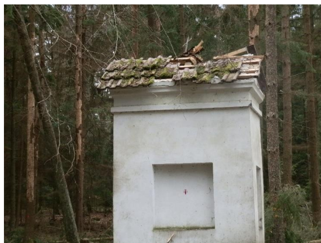
Zničená střecha kaplička sv. Háty po polomu.
